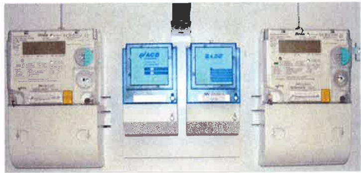
Neben den Zählern wird im Schaltkasten der EEG-Anlage das Zählerfernausslesemodul von ACD montiert.
