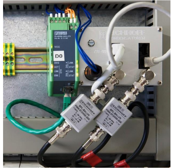
Übergabe des Datensignals auf das BNC-Kabel – hier mit Filtern zur Störungsminderung gezeigt – zur PLC-Einkopplung in die Mittelspannungsleiter.
