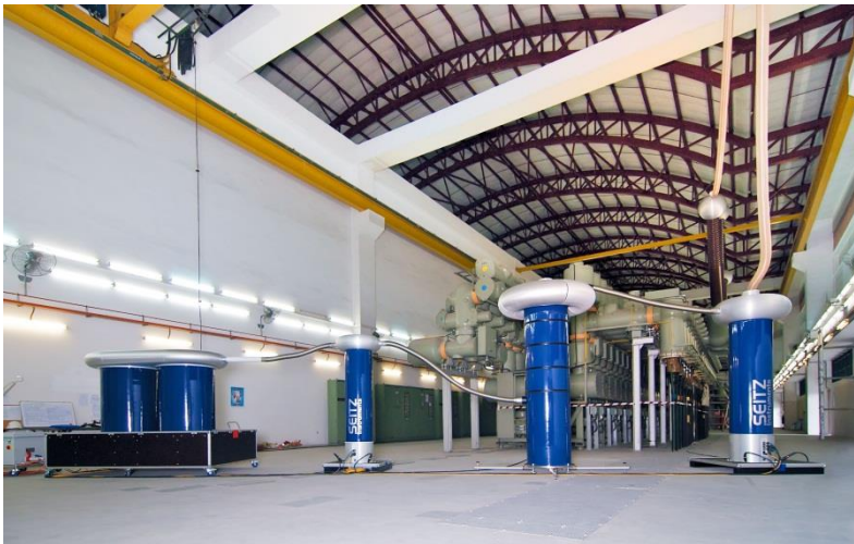
onsite-high-voltage-Produkte im Einsatz
