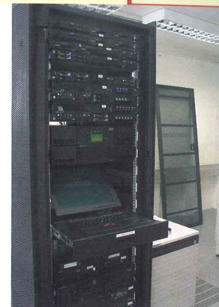
Serverschrank im WEVG-Rechenzentrum.
