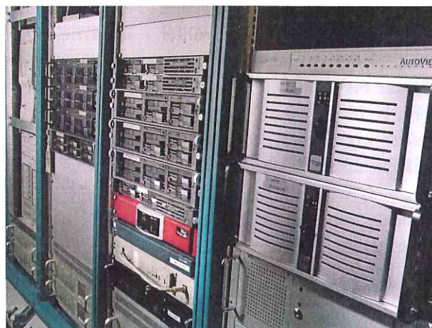
Rechenleistung für Dritte: Server-Raum der Stadtwerke Herborn.
