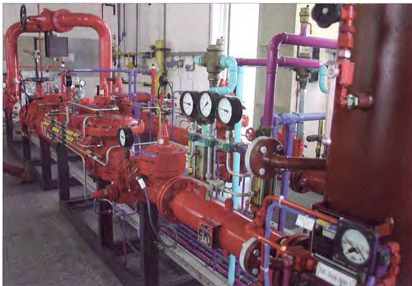
EDM auch für den Gasmarkt – die Gasübergabestation Armensünderweg in Speyer
