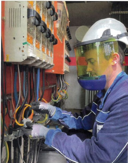
Im Einsatz bei den Stadtwerken Kempen: mobiler Fernwirkkoffer zur Identifikation möglicher Überlastungen im Niederspannungsnetz. Sicherheit und Zuverlässigkeit mit größtmöglicher Flexibilität in der Anbindung: via MQTT in die Cloud und/oder über IEC 60870-5-104 an ein Leitsystem Bildquelle (alle Bilder): SAE IT-Systems / Lacroix Environment
