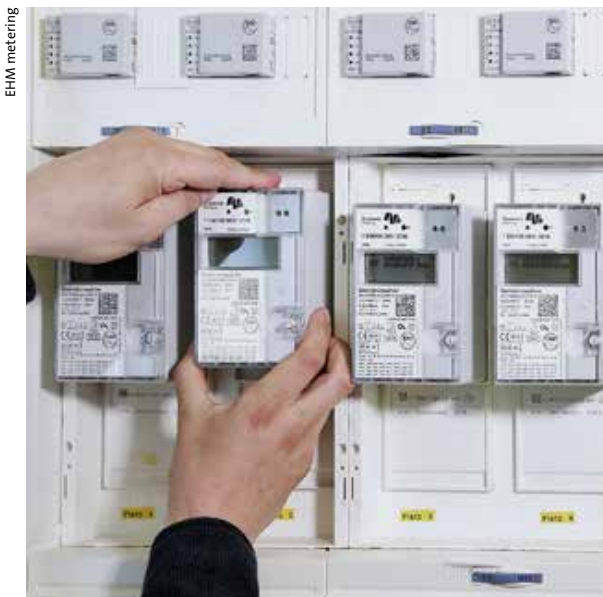
Die Energieversorgung Filstal setzt unter anderem auf Basiszähler von EHM.
